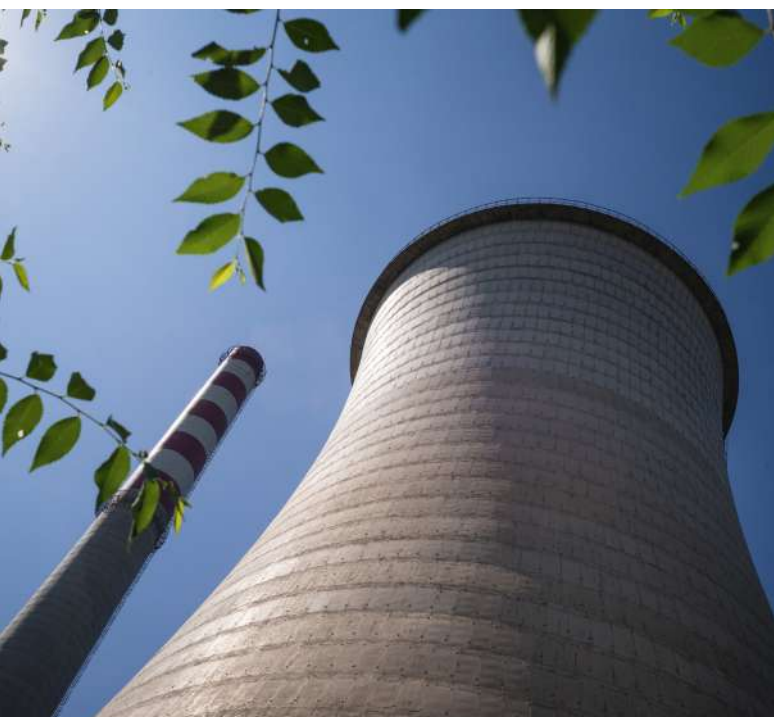
Tour de refroidissement.
